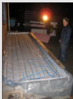
Varmekabler i gulv Opphavsmann: Google
